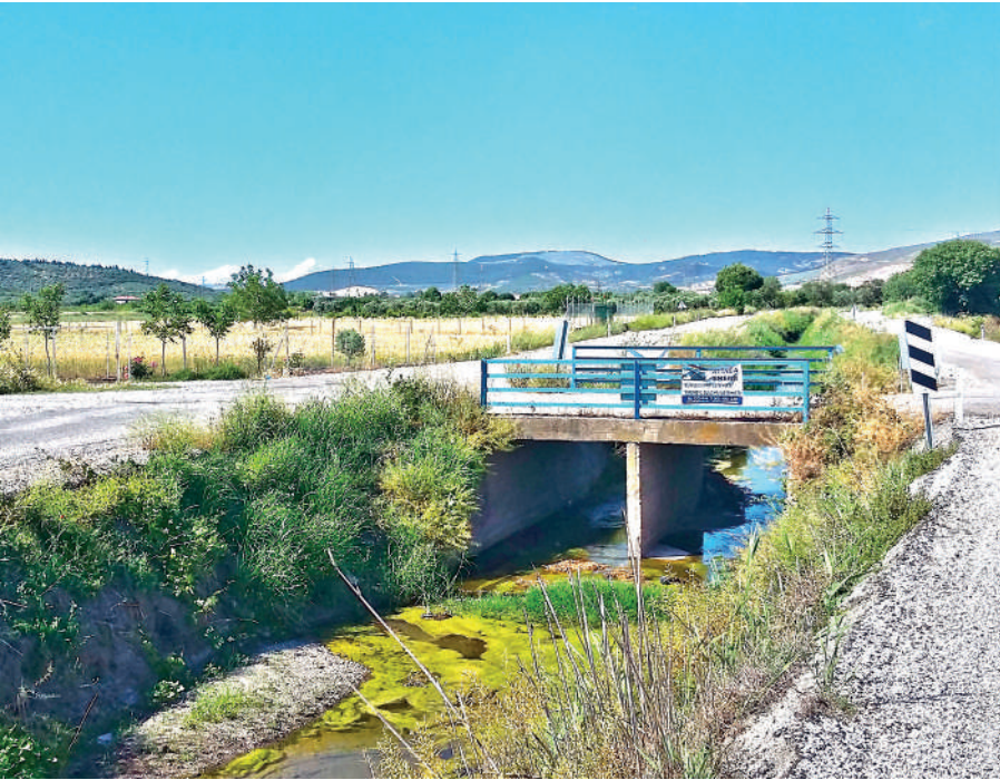
Foto 106 Helvacı Ovası'ndaki kurutma kanalının görünüşü.
